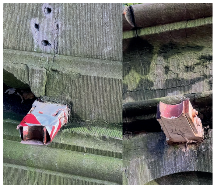
De afgezaagde doken (in lood gegoten bevestigingspunten) van het hek in de kolommen. Foto: auteur.
