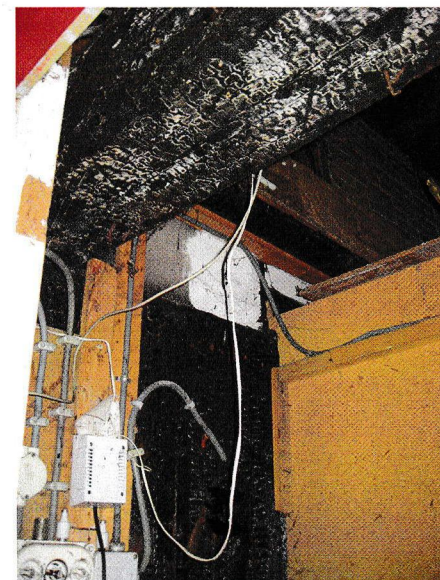
In de meterkast zit een geblakerde balk.
